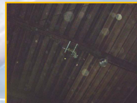
消臭ミスト設備
