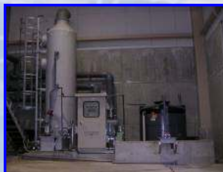
薬液脱臭装置 (スクラバー)
